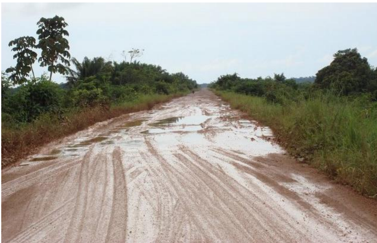
Figura 4: Exemplo de pavimento em estado considerado péssimo.
